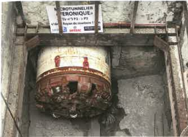
Figure 2 : Arrivée du microtunnelier baptisé Véronique à son puits de sortie [Photo crédit : SADE] / Arrival of microtunnel boring machine Véronique at its reception shaft [Photo credit SADE]
